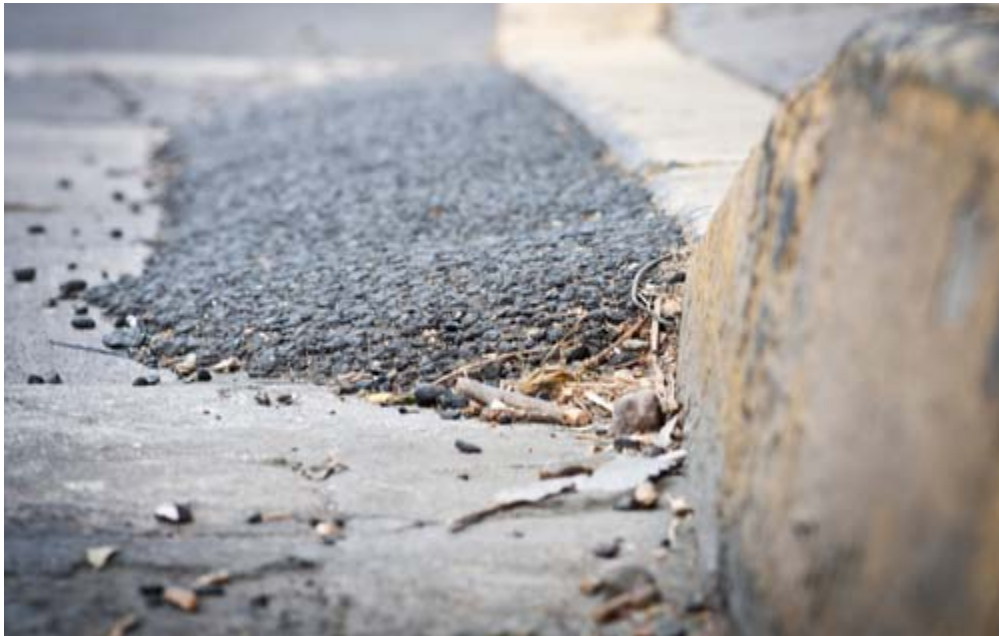
Detalle de relleno de plinto en contraste con el desnivel del rebaje de solera
