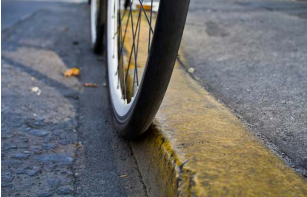
Detalle de desnivel en rebaje de solera o "plinto" en acceso vehicular motorizado
